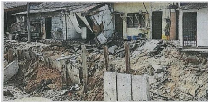
■多家食肆后方因 泥土流失出现坍塌， 情况严重。
